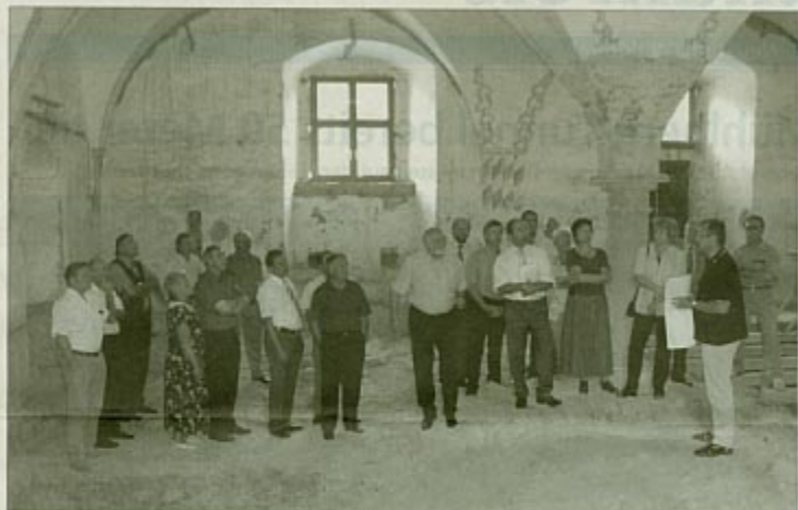
Technischer Amtsrat Johann Schütz (2.v.r.) erklärte als Mitarbeiter des staatlichen Hochbauamtes der CSU-Kreistagsfraktion die anstehenden Sicherungs- und Sanierungsmaßnahmen in der Friedrichsburg. Die statische Sicherung von Gewölben und Säulen wird ein Schwerpunkt der Arbeiten sein.
